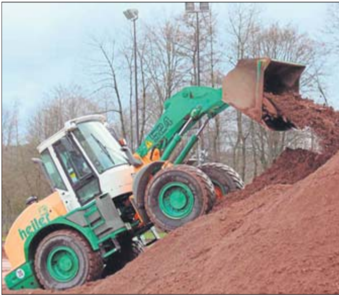
Innerhalb von acht Wochen wird die Firma Heiler den Aschenplatz des TuS Belecke in einen Kunstrasenplatz umbauen.
