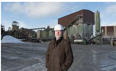
In diesem Bereich wird eine neue Aufbereitungsanlage und die Zentralverladung installiert (Bild: NRW.BANK)
